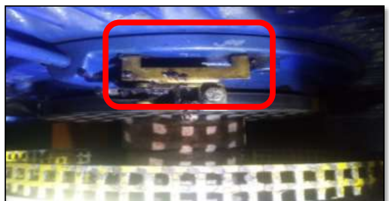
Fig. 5 – Carbón de baja resistencia eléctrica desgastado.
